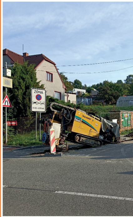
Vodovod Za Puchárnou
